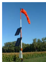
Sistema de Iluminación basado en Energía Solar
